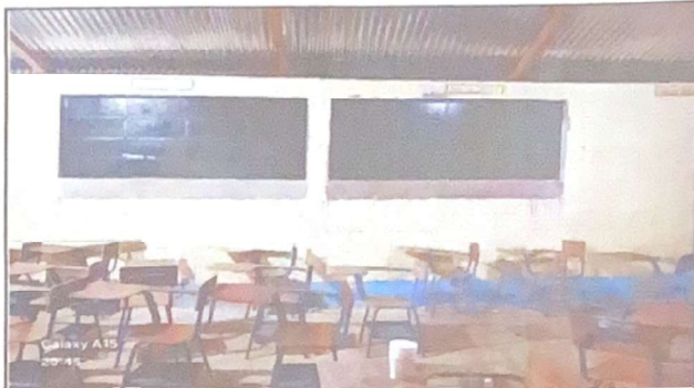
Foto 4: En esta parte se observan ventanas.
